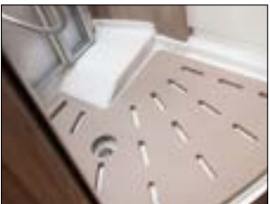
Holzboden in der Dusche
